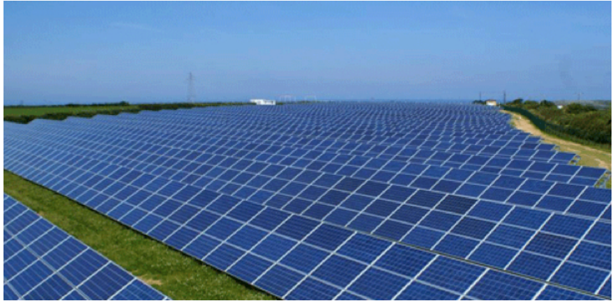
Fotoğraf 1: Fotovoltaik teknolojisi ile elektrik üreten paneller.
